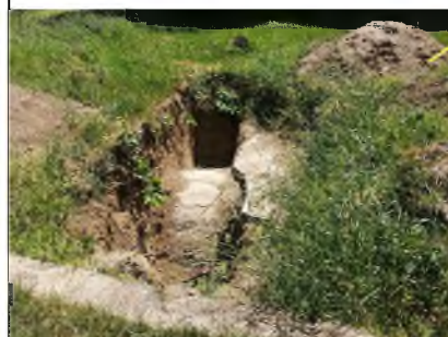
Зацељен Таџин поток пролази ивицом предметне парцеле у правцу ул. Љубишке, Ø160
